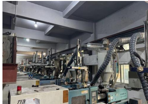
废气集气罩及管路
