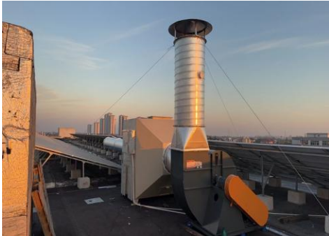
15m 高排气筒
